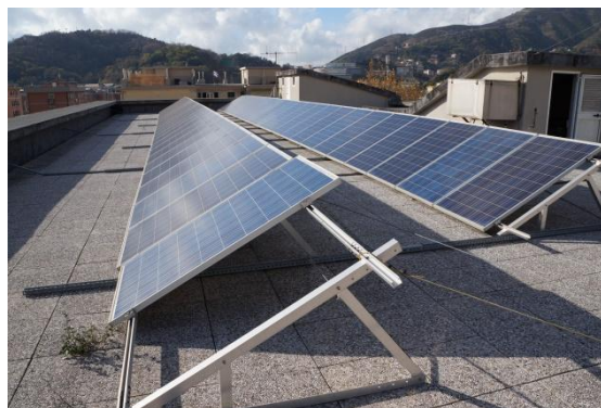
Figura 4.20 - Vista dell’impianto fotovoltaico
