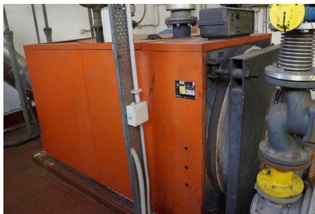
Figura 8.5 – Particolare generatore di calore
