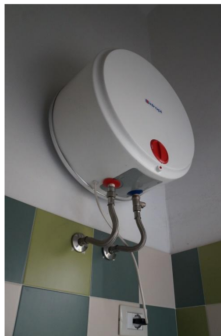
Figura 4.15 - Particolare di un boiler elettrico per la produzione di acqua calda sanitaria
