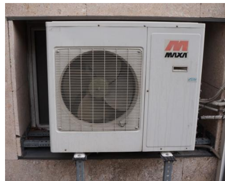
Figura 4.16 - Particolare di una unità esterna per la climatizzazione degli uffici comunali
