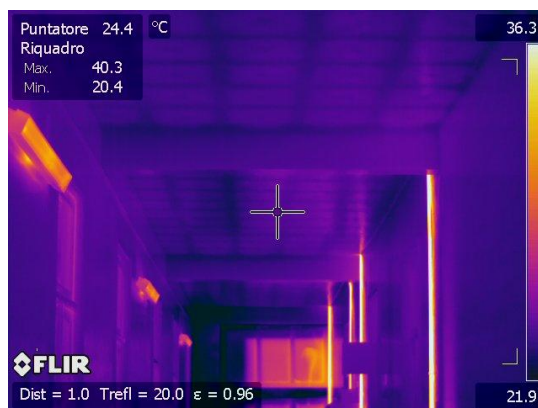
Figura 8.3 – Particolare termografia solaio
