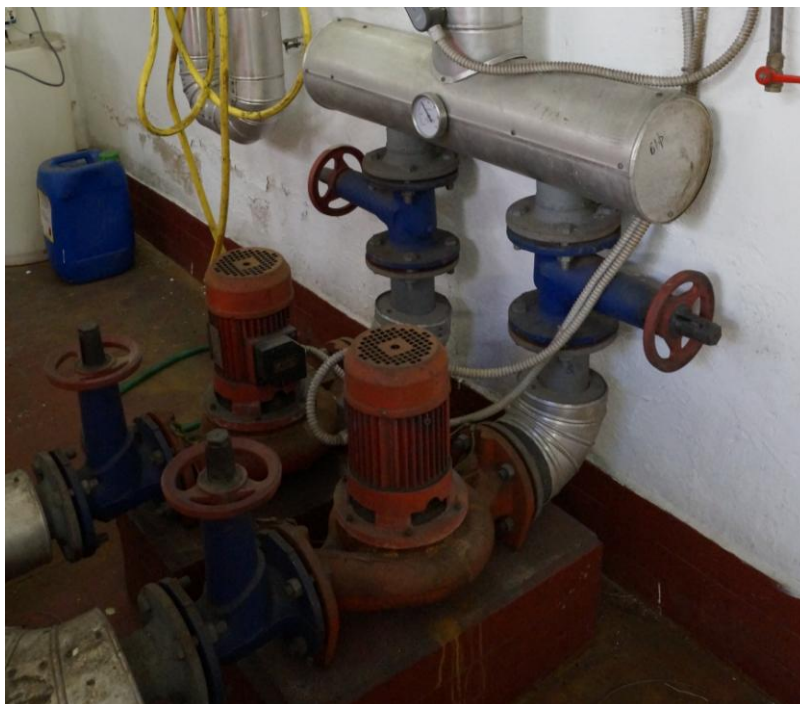
Figura 8.9 – Particolare pompe di circolazione
