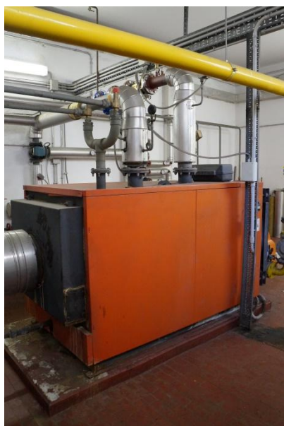
Figura 4.13 - Particolare del generatore di calore installato all’interno della centrale termica a servizio dell’edificio scolastico e della casa del custode
