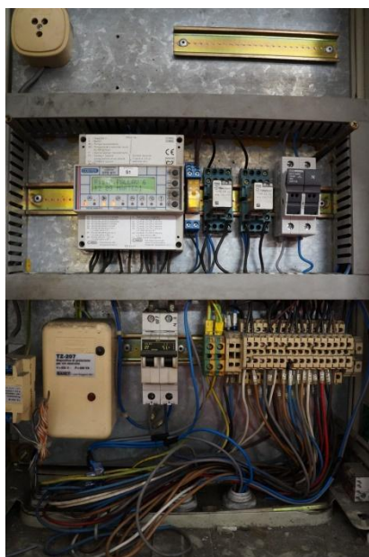
Figura 4.9 – Centralina di controllo situata all’interno della centrale termica a servizio dell’edificio scolastico
