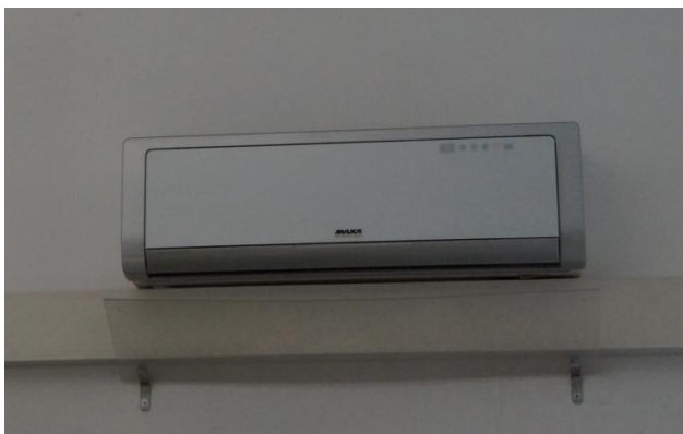
Figura 4.7 – Particolare di unità interna installata in un ambiente degli uffici comunali
