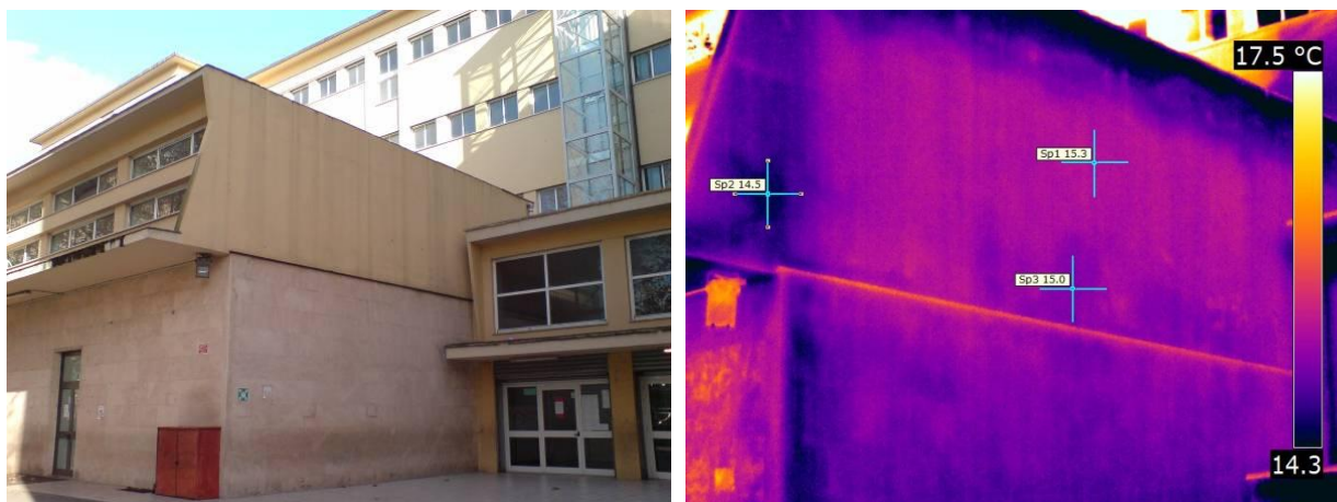
Figura 4.3 – Rilievo termografico della parete nord del blocco palestra
