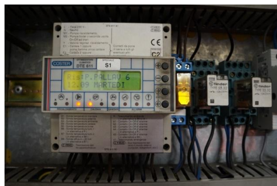
Figura 4.10 - Particolare della centralina di controllo in centrale termica
